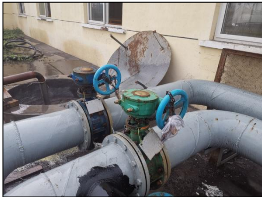
雨水总排口控制阀
