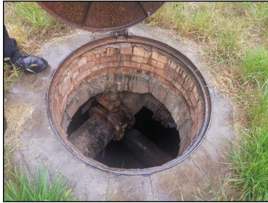
事故水收集管网切换阀
