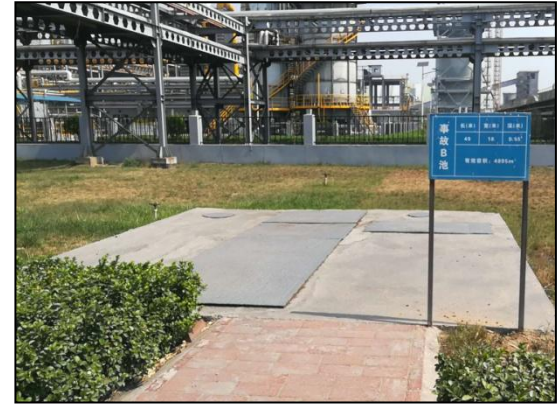
地埋式事故池
